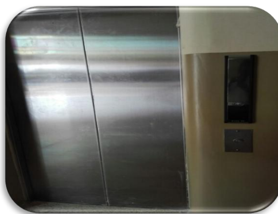
Figura 21: Implementación de Ascensor Fuente: Administración General
