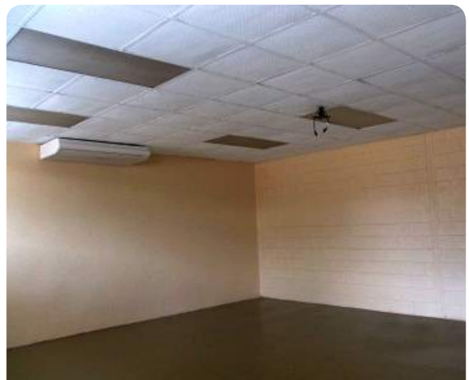
Figura No. 299: Climatización en las aulas de la Carrera de Derecho Fuente: Dpto. de Administración General
