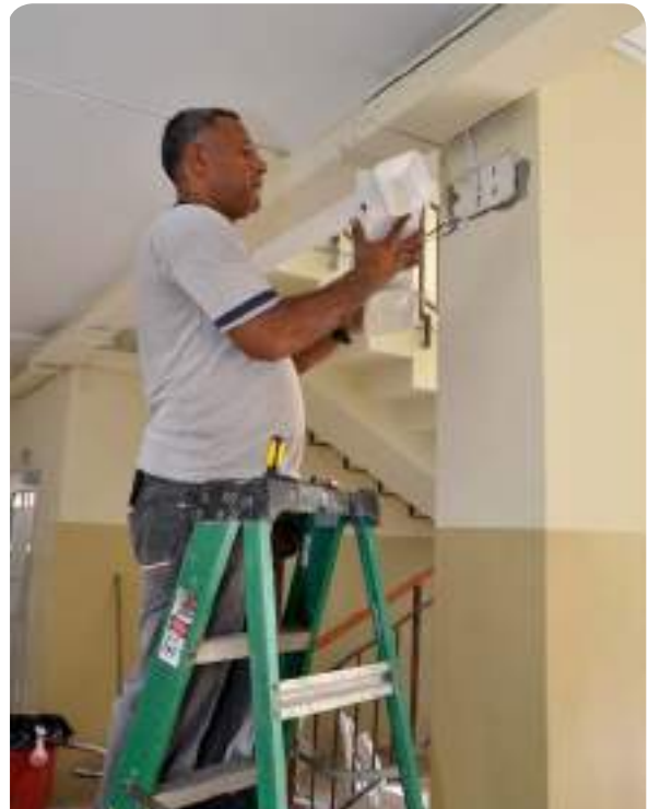
Figura No. 308: Revisión y cambio de lámparas de emergencia
