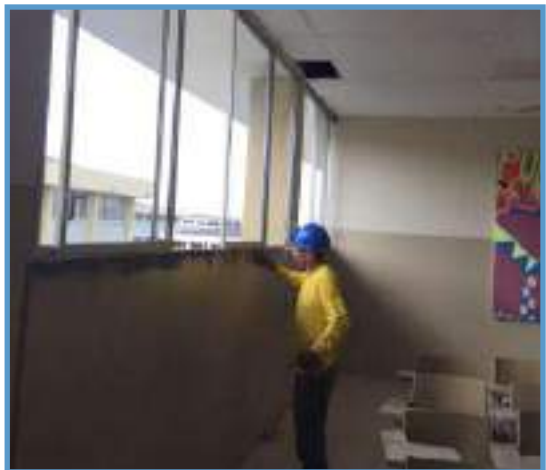
Figura No. 545: Reparación de fisura y pintada de aula en el Edificio Principal
