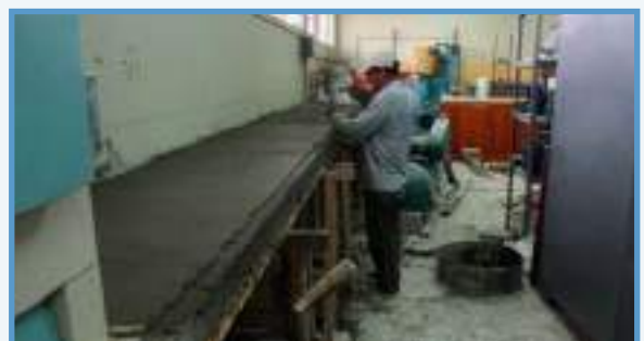
Figura No. 531: Construcción de mesones de hormigón armado en el Laboratorio de Suelos
