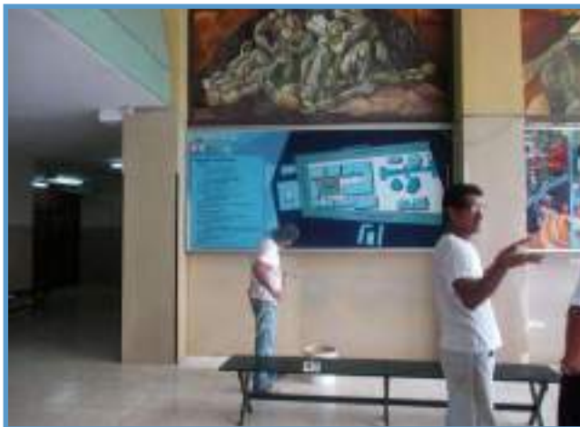
Figura No. 546: Reparación de paredes y pilares del hall del Edificio Principal
